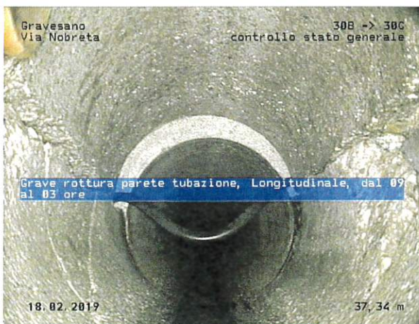
Rottura parete e giunto difettato
