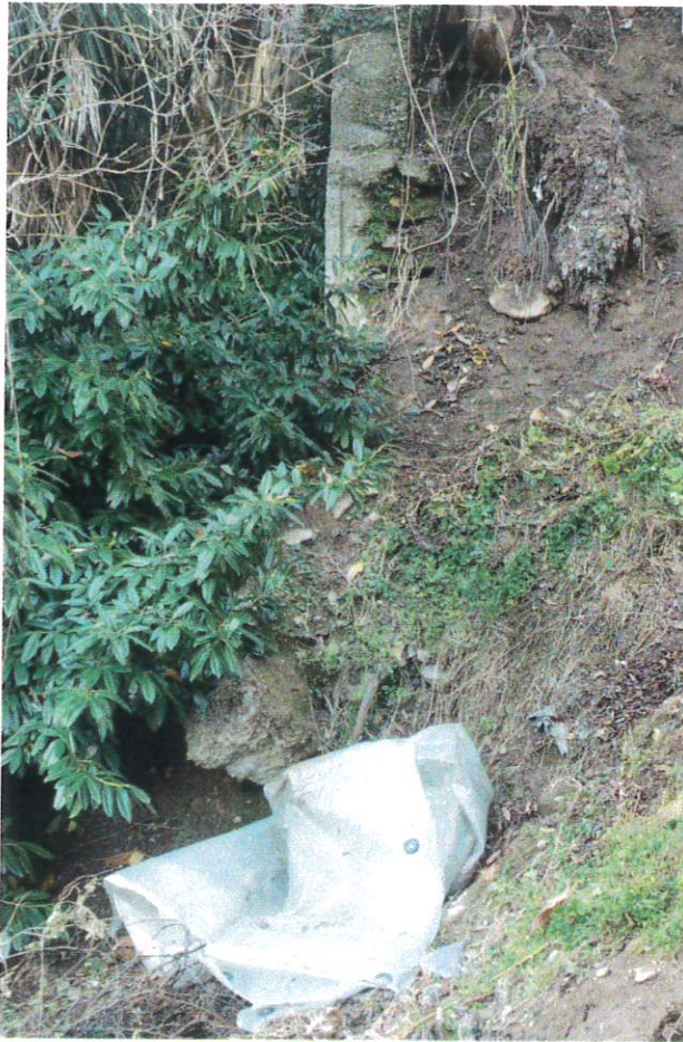
MURO DI SOSTEGNO FRANATO
