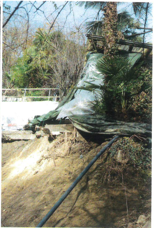
TERRENO FRANATO SOTTO AL POLLAIO
